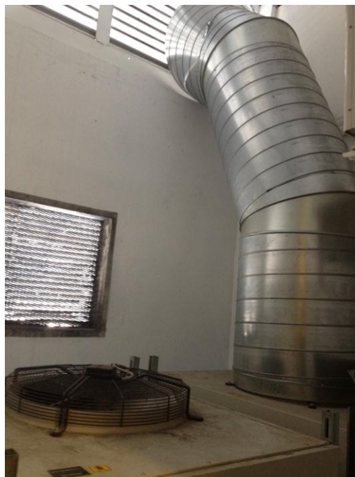
Photo 1 : Local des aéro-condenseurs
